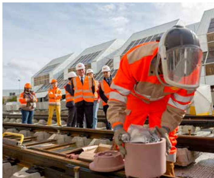
Le plus gros des travaux du centre-ville devraient être achevés en fin d'année.
